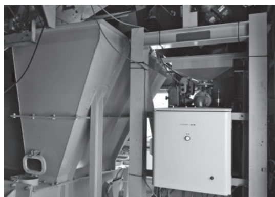
モルタルと専用溶液に分離する計量フロア
